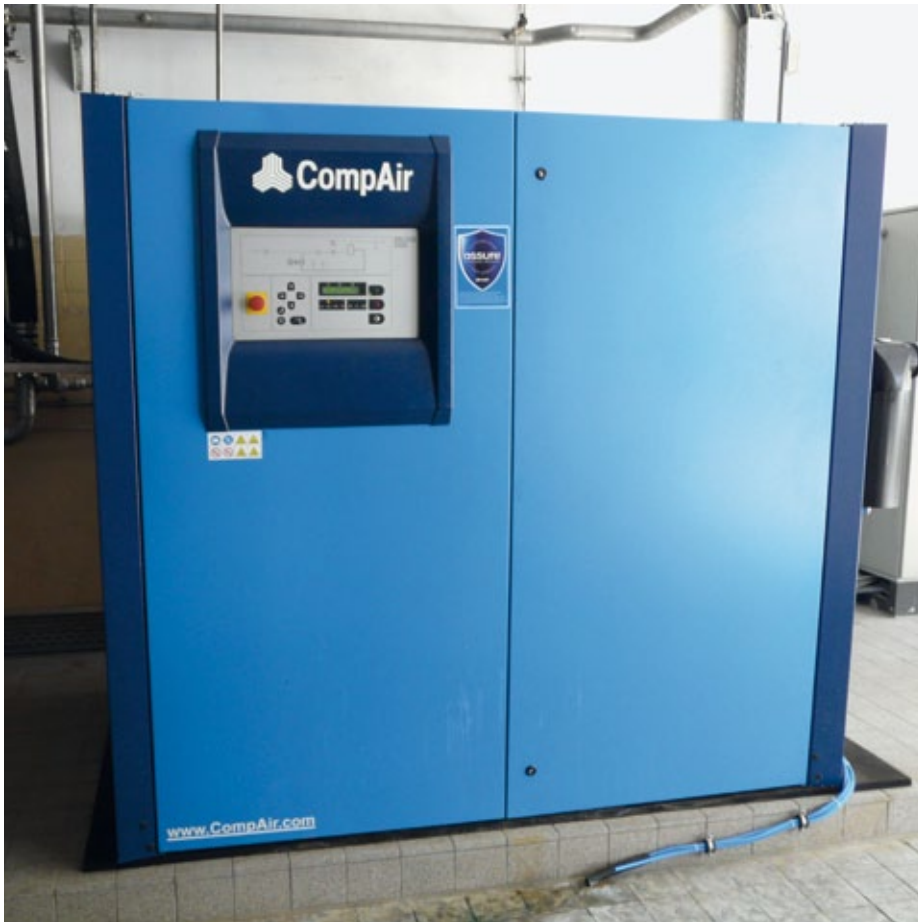
■ Abb. 4: Die ebenfalls frequenzgeregelte Pureair-Maschine mit 110 kW Leistung übernimmt die Grundversorgung der Brauerei mit ölfreier Druckluft. © Compair
