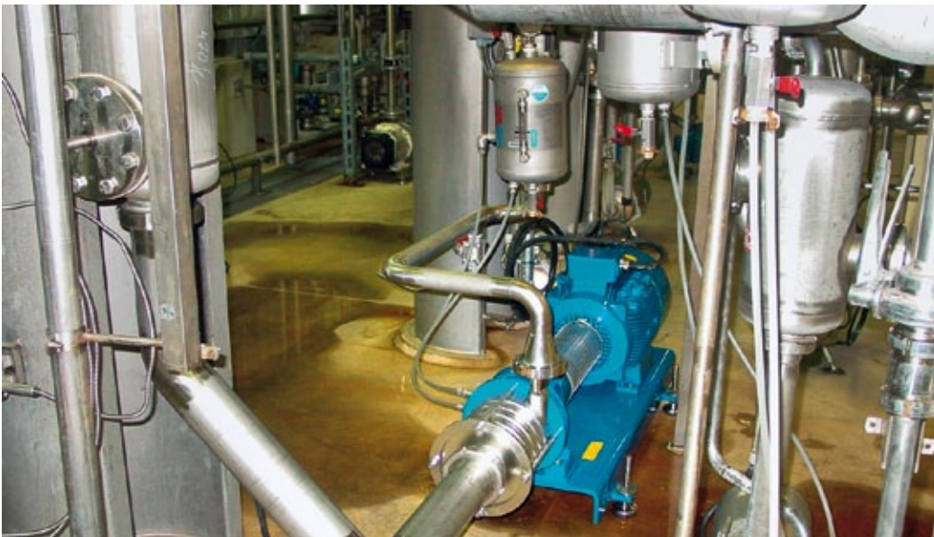
■ Abb. 2: Einsatz einer horizontal angeordneten Contra-Pumpe in der Zuckerindustrie.
