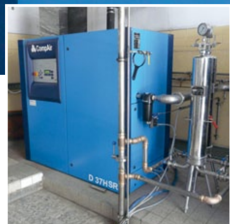
■ Abb. 3: Zuerst wurde ein kleinerer frequenz geregelter Pureair-Verdichter angeschafft. © Compair
