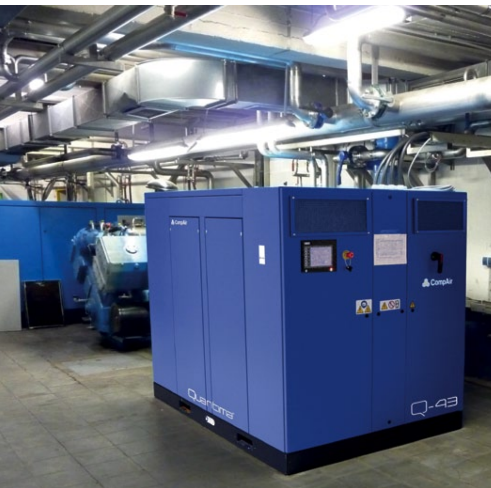
■ Abb.: Druckluftstation mit vier ölfrei arbeitenden Kolbenkompressoren und dem neuen Quantima-Kompressor für die kostensparende Erzeugung ölfreier Druckluft.
