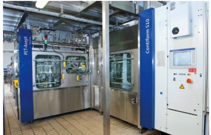
■ Abb.: Erstmals überhaupt ist bei L'Abeille die Contipure mit Isolator als kleinem Reinraum und einem aseptischen Füller realisiert.
