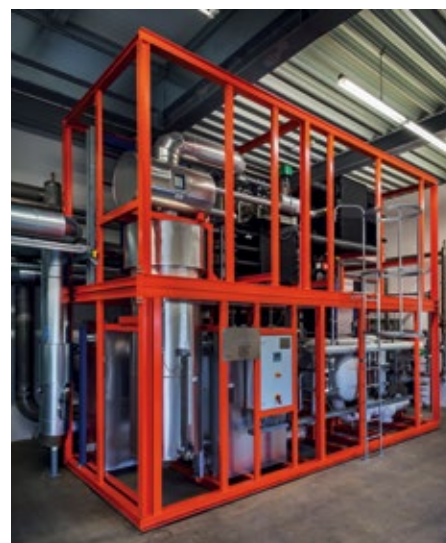
■ Abb. 2: Das neue BHKW in der Innenansicht, die Inbetriebnahme der zweiten Ausbaustufe ist für Februar 2014 geplant.
