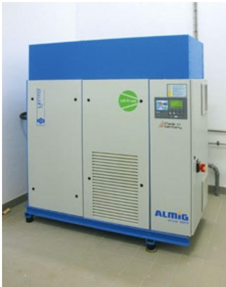
■ Abb. 2: Der wassereingespritzte Schraubenkompressor Lento 22 bei Prolupin.
