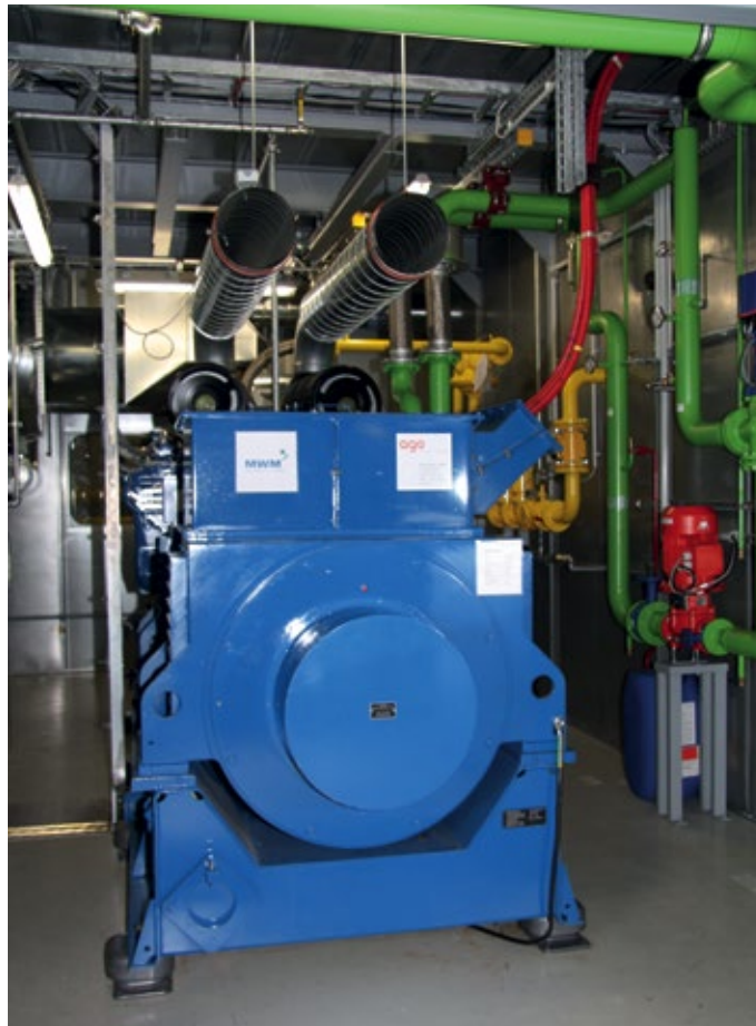
■ Abb. 2: Bei der Warsteiner Brauerei erzeugt das BHKW eine Leistung von jeweils 2,3 Megawatt thermischer und elektrischer Energie und deckt die elektrische Grundlast der Produktionsstätte zu ca. 40 % ab.
