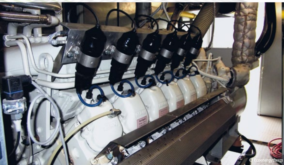
■ Abb. 1: Blick in ein BHKW-Containermodul von Yados: Zu sehen ist die linke Motorreihe des V12-Motors mit Abgasstrakt und Turbolader.
