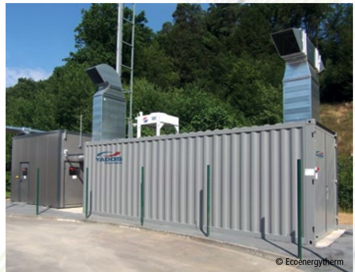
■ Abb. 2: Energieintensive Industrien wie die Molkereiindustrie können je nach energetischen Voraussetzungen mit Hilfe von KWKK-Anlagen große Einsparpotenziale nutzbar machen.
