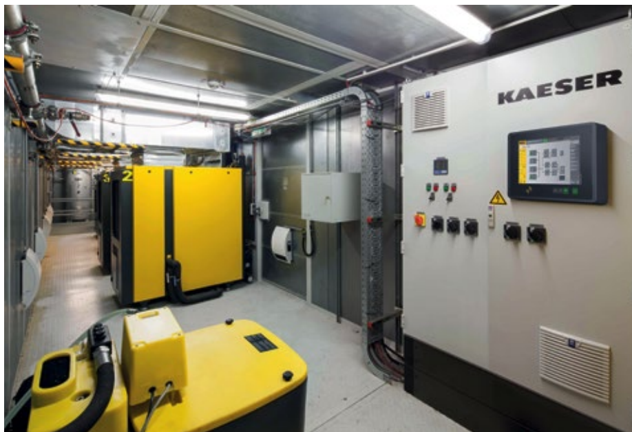
Abb. 3: In der Station selbst kommunizieren die einzelnen Komponenten zur Druckluftzerzeugung mit der übergeordneten Steuerung.
