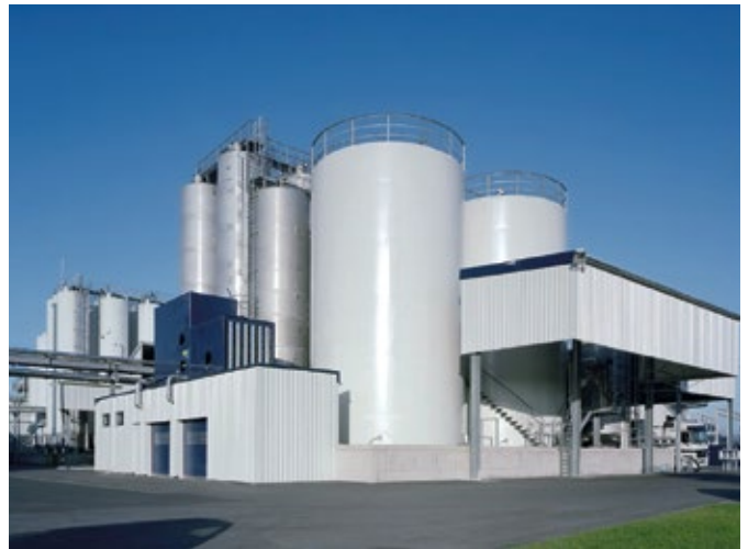
Das Werk der KS-Recycling GmbH am Hauptsitz Sonsbeck.
