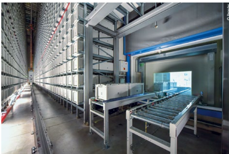
Abb. 3: Rund 10.000 Kisten haben im Lager Platz. Ein Regalbediengerät befördert bis zu 240 Kisten pro Stunde von und zu den Rollbahnen. Der gesamte Bereich ist als Sauberraum.
