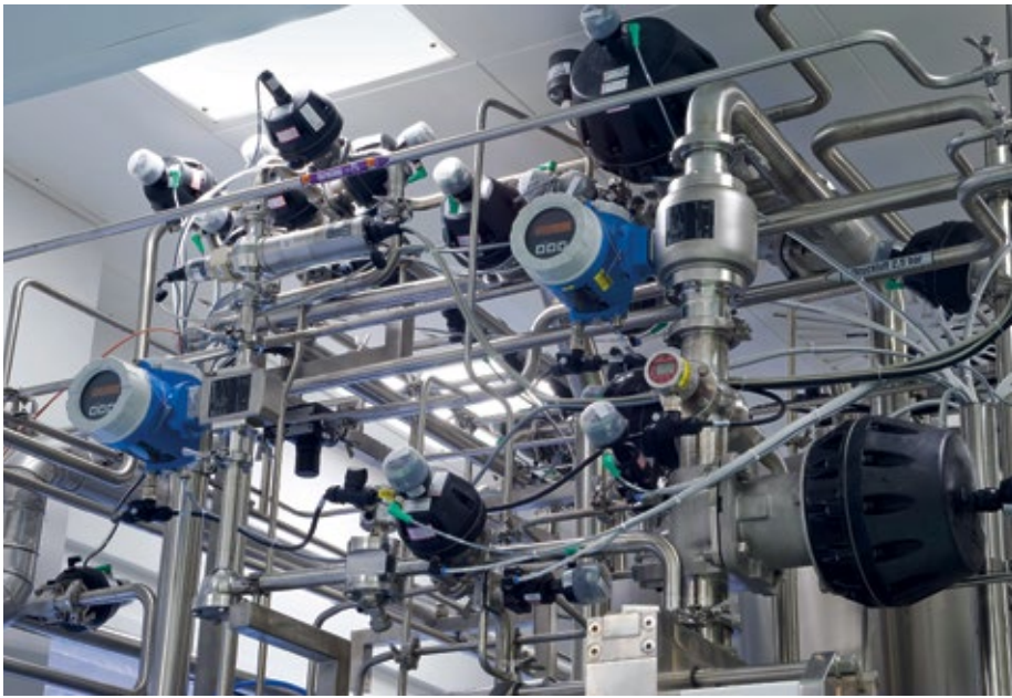
Abb. 3: Der Platz für Messgeräte in Prozess Skids ist begrenzt.
