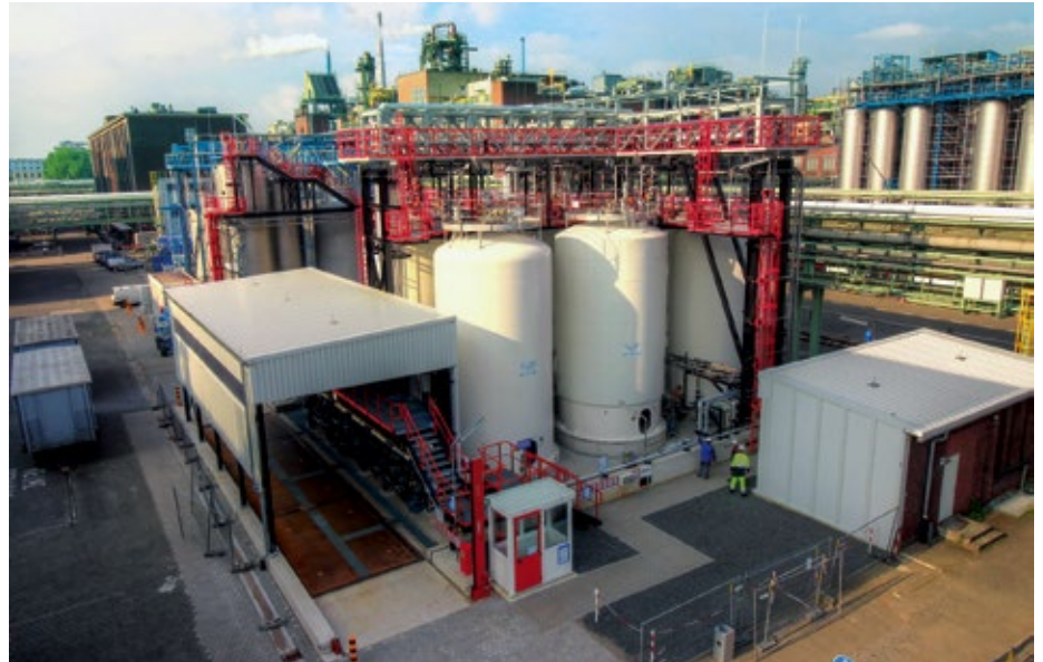
Abb. 1: Das Tanklager besteht aus insgesamt 6 Tanks. Die Entladestation dient zur Rohstoffübernahme aus Tanklastwagen und Tankcontainer über Bodenentladearme ins Tanklager.
