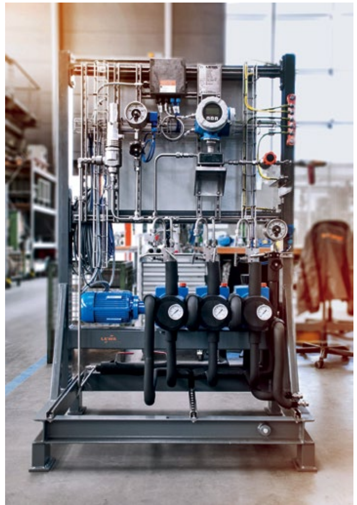
Abb. 2: Die Ecofoam Anlage besteht aus einer Ecoflow Dosierpumpe, einem saugseitigen Schmutzfänger und zwei Kontaktmanometern zur Drucküberwachung in der Rohrleitung.
