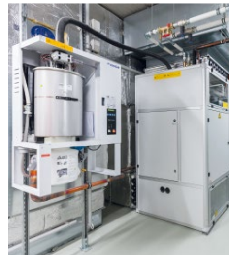
Abb. 6: Weiss Klimatechnik: Die Klimazentrale mit Weiss Umluft-Klimakompaktgeräten zentraler Außenluftaufbereitungsanlage sowie separatem Befeuchtersystem
