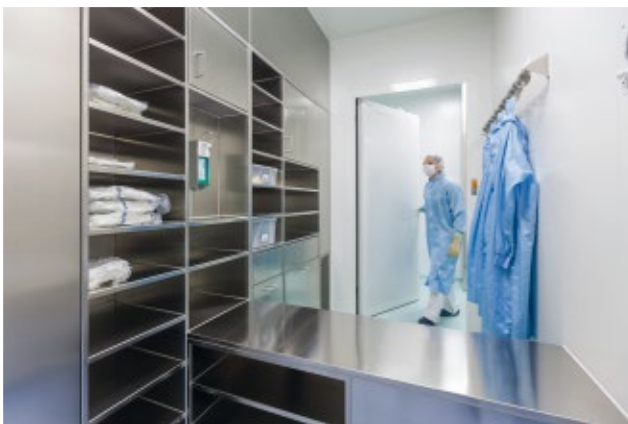
Abb. 5: Sailer: Alle Personalschleusen wurden von Sailer auf den Ein- und Auskleideprozess von CuraFaktur abgestimmt und vorab in 3D geplant.
