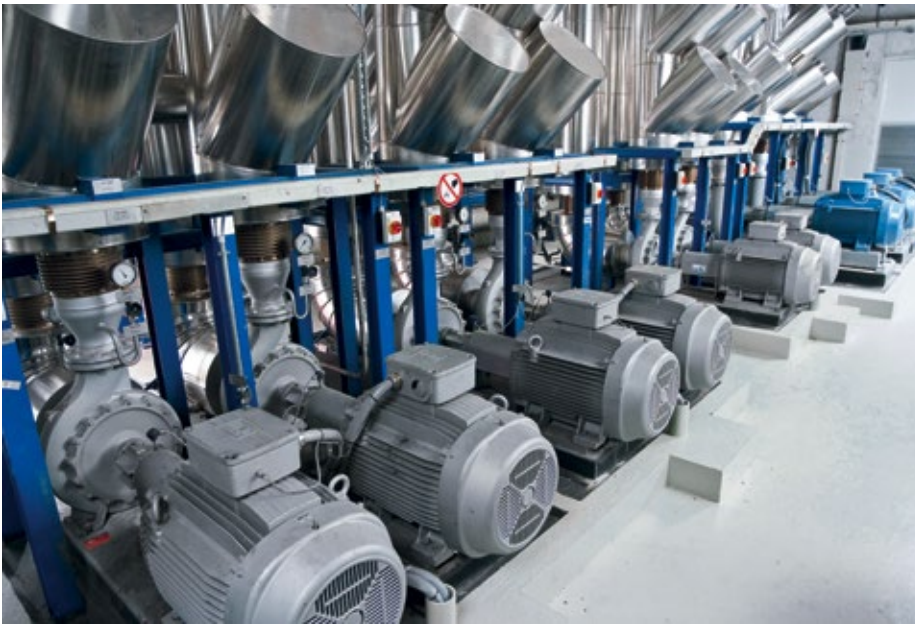
■ Abb. 2: Vor allem in Bestandsanlagen gibt es bei den installierten Pumpen noch viel Potenzial, um die Betriebskosten zu senken.
