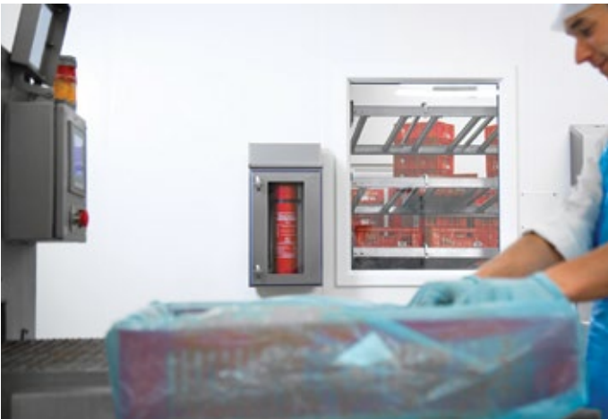
Abb. 2: Die Feuerlöscher in der Produktion sind in Edelstahlgehäuse aus der Serie Hygienic Design von Rittal untergebracht
