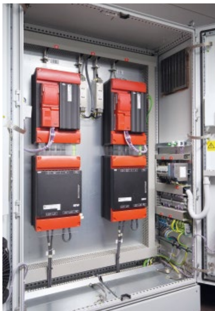
Abb. 3: Die berührungslose Energieversorgung wird über das Movitrans System realisiert. In Summe 22 Einspeisesteller bringen die Energie auf die Linienleiter im Reinraum.
