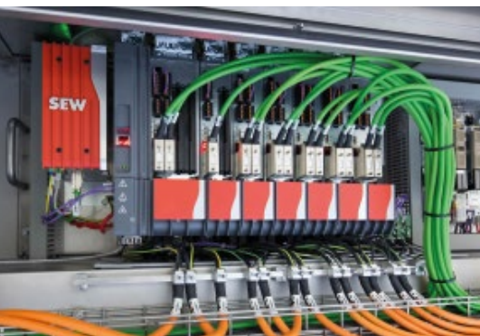
Abb. 2: Auch bei sehr beengtem Bauräumen ist der Automatisierungsbaukasten MOVIE-C die richtige Wahl. Im Bild: MOVIE-C Controller power, das Mehrachssystem Movidrive modular mit Versorgungs- und Achsmodulen (v. l.)
