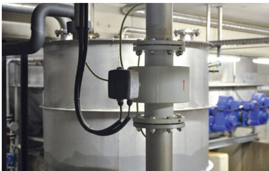
Abb. 3: Auch bei starken Verunreinigungen im Medium noch zuverlässig: die Transmag 2 in der Innsbrucker Kläranlage händeln bis zu 40m3 pro Stunde
