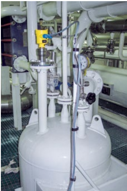
Abb. 1: Der Vegapuls 64 misst den Füllstand in einem Kühlsystem an Bord eines Gastankers.
