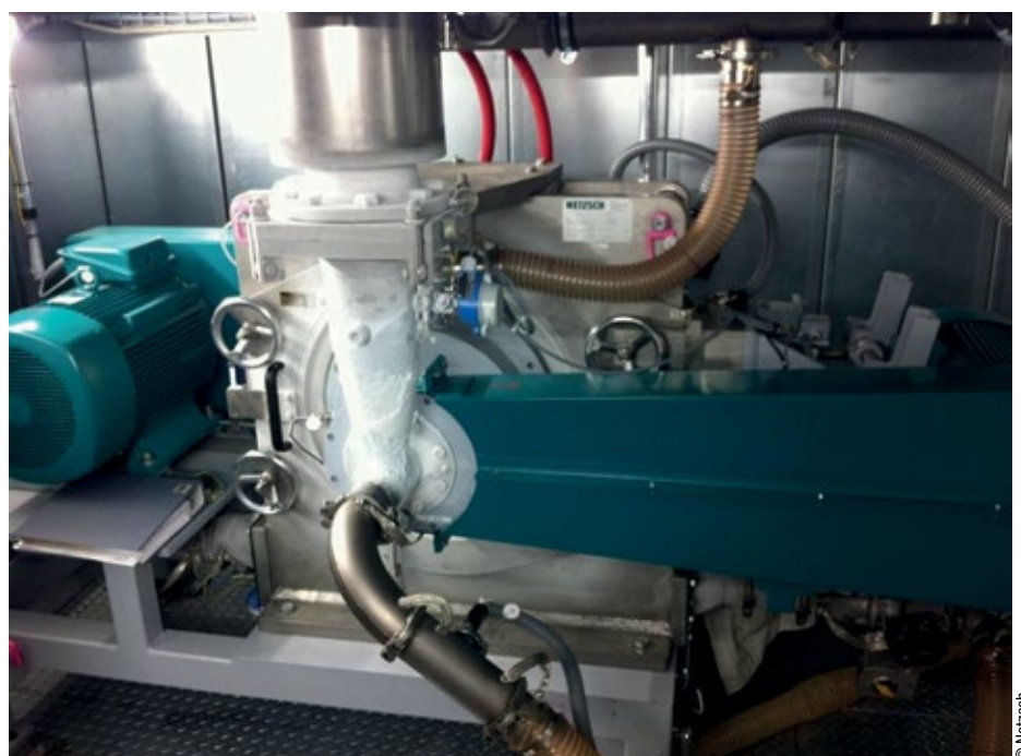
Abb. 1: Prallmühle Condux mit angeschlossener Siebmaschine zur kryogenen Vermahlung im inerten Kreisgassystem.
