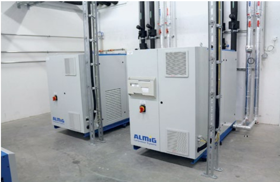
Abb. 2: Losan Pharma setzt auf zwei direktgetriebene, drehzahleregelte Schraubenkompressoren der Type Variable 55 von Almig.
