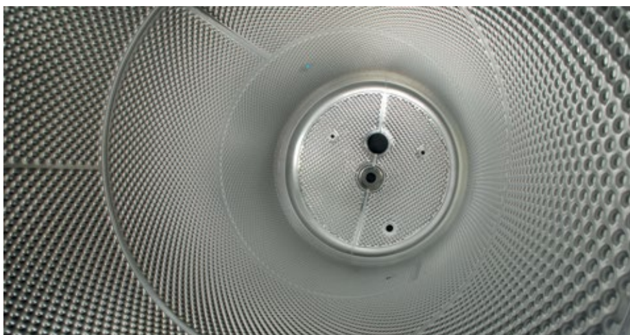
Abb. 1: Blick in den Reaktionsbehälter mit WTP-Innenmantel
