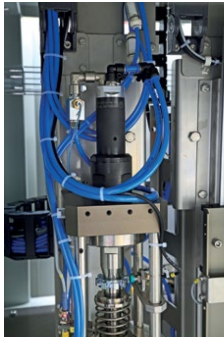
Abb. 2: In den Anlagen öffnen und verschließen LZB-Druckluftmotoren die 60- und 200-l-Fässer prozesssicher mit dem richtigen Drehmoment.
