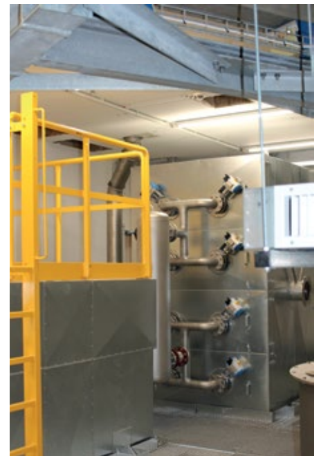
Abb. 3: Schlauchfilter (vorne), Heißgasfilter mit horizontalen Filterelementen und CPP Regeneration (hinten)
