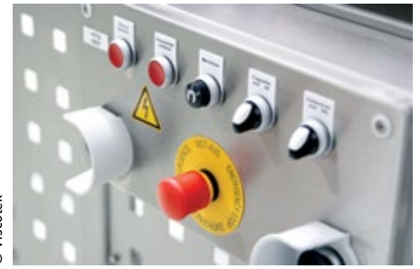
■ Abb. 3: Steuerung für das Entleersystem.
