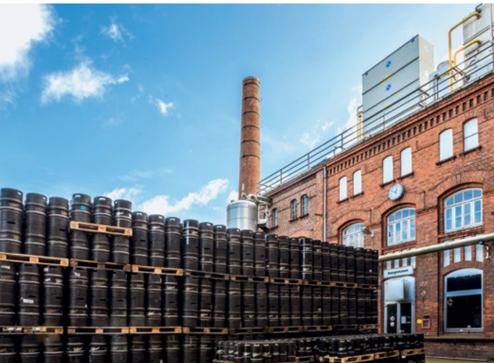
■ Abb. 1: Blick auf die Energiestation der Brauerei mit Heißwasserspeicher, Kältekompressoren und Rückkühlwerken auf dem Dach.
