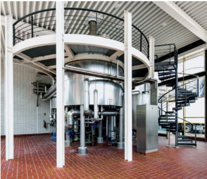
■ Abb. 2: Im Sudhaus entsteht bei einem energieintensiven Prozess aus Wasser, Malz und Hopfen die zuckerhaltige Würze.
