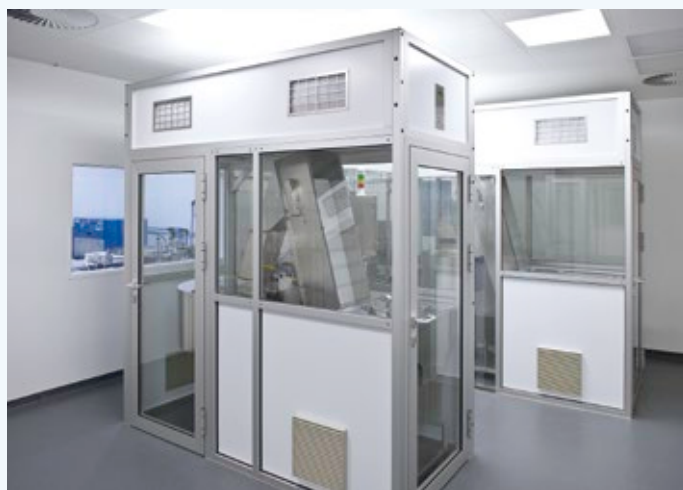
Abb. 4: Gesamte Reinraum-Einhausung der Abfüllmaschine.
