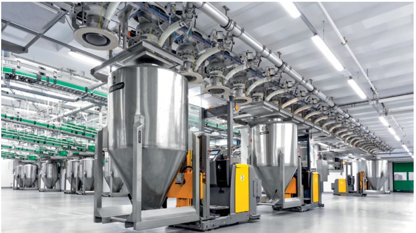
■ Abb. 1: Vollautomatisches Absammelsystem mittels Daxner Container Systems DCS in Verbindung mit dem fahrerlosen Transportsystem FTS. Container der Serie DCHD in Hygienic Design, Nutzinhalt 1.200 L, CIP-fähig.
