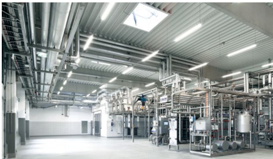
Abb. 2: Bei der Realisierung des „Alles aus einer Hand“-Projektes bei der Meiereigenossenschaft Viöl stand IE vor einer ganzen Reihe technischer Herausforderungen, die aufgrund der Voraussetzungen vor Ort spezielle Lösungen erforderten.
