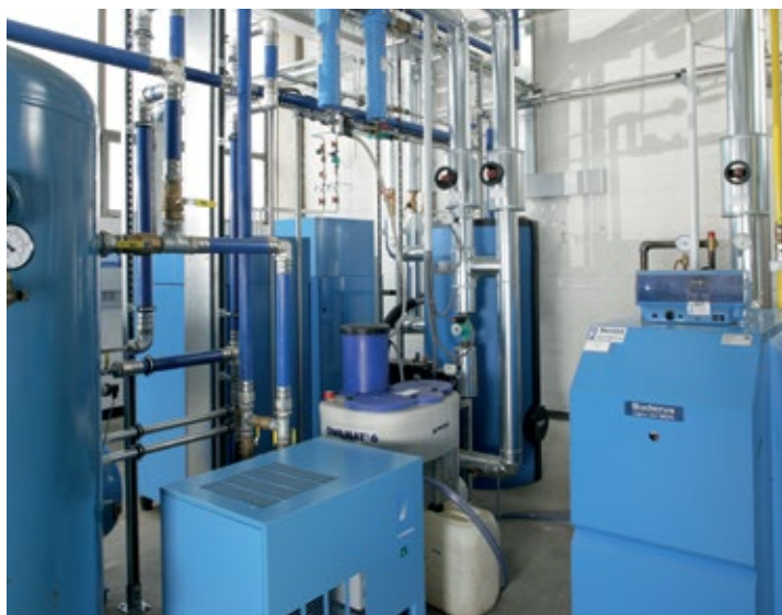
Abb. 3: Die Wärme, die bei der Druckluftherzeugung entsteht, kann zum Beispiel zu Heizzwecken genutzt werden – wie hier am Firmensitz von Boge in Bielefeld.
