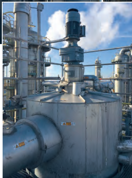
Abb. 3: In diesem Rührwerk ist eine Chetra Typ 500 verbaut.
