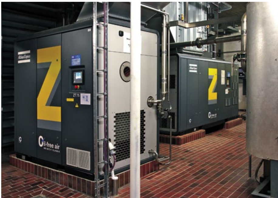
■ Abb. 2: Im Maschinenhaus 1 ist eine neue Druckluftstation entstanden. Hier stellen die ölfrei verdichtenden Schraubenkompressoren ZT 75 und ZT 132 VSD von Atlas Copco Steuerluft bereit.
