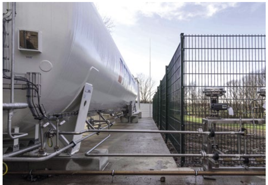
■ Abb. 3: Autarke Energiequelle: Der Spezialtank zur Lagerung von tiefkaltem LNG (-149 °C) ist vakuumisoliert und verfügt über eine Doppelwandausführung.
