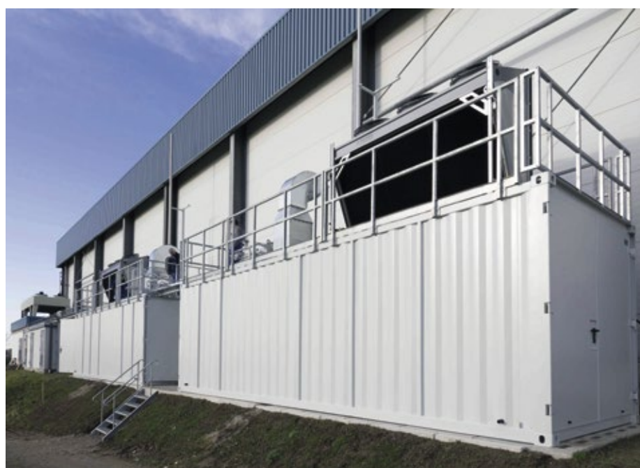
■ Abb. 1: Außenansicht der zwei identischen Energiezentralen am Zielstandort in Döbeln. Yados entwickelte und konfektionierte die Anlagen als mobile und flexibel erweiterbare Container-Lösung.
