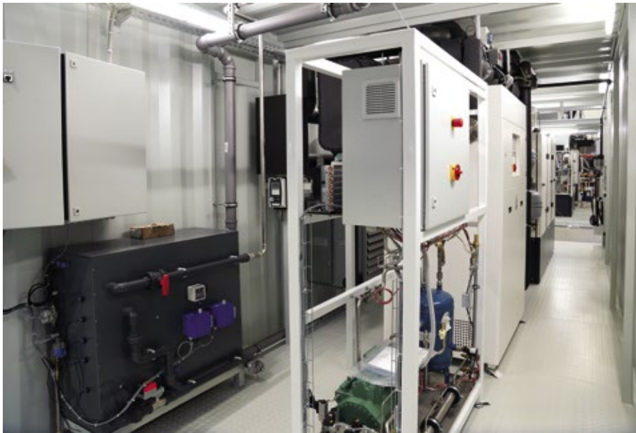
■ Abb. 2: Die im Container verbauten Energiezentralen beinhalten jeweils ein BHKW-Modul, eine Absorptionskältemaschine, eine CO 2 -Verdichter-Kaskade (Tiefkühlkaskade) sowie die Leit- und Steuerungstechnik Yado|Link zur Überwachung aller Systemprozesse.
