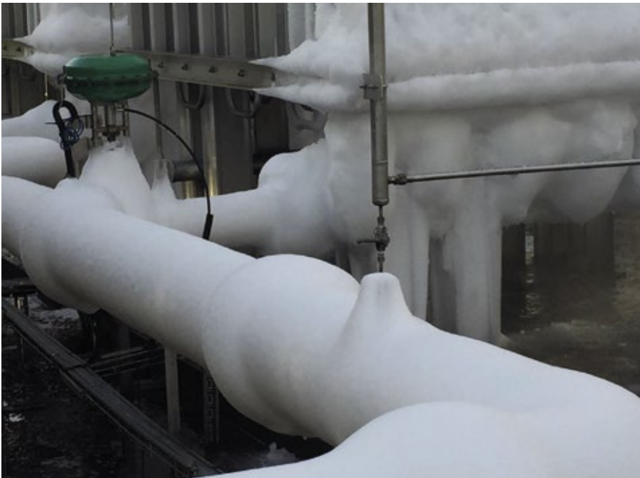
Abb. 4: Vereiste Gasleitungen zeigen das Kältepotenzial von LNG auf: Bislang wurde die bei dem Regasifizierungsprozess von Flüssigerdgas freiwerdende Kälte ungenutzt in die Umwelt abgegeben.
