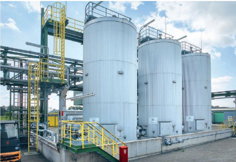
Abb. 3: Kundenspezifisch werden die Flüssigkeiten aus dem Komponentenlager gemischt und direkt in Lkws verladen
