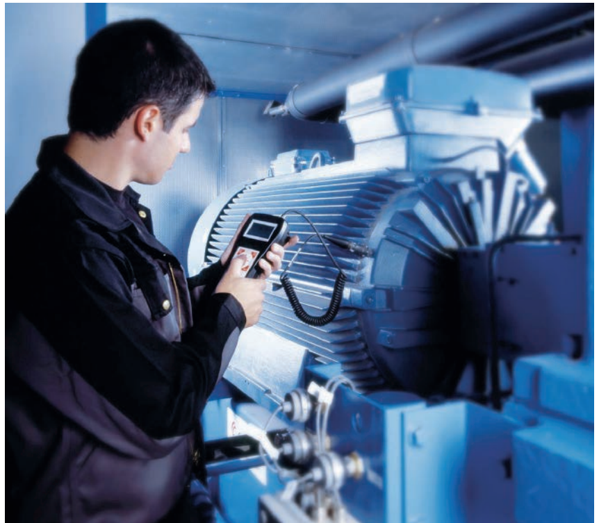
Abb. 4: Schwingungsmessungen geben Aufschluss über den Zustand des Innenlebens einer Verdichterstufe
