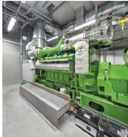
■ Abb. 2: Ein neues BHKW dient zur Erzeugung von Strom, Wärme und Dampf sowie zur Warmwasseraufbereitung für die Pasteurisierung.
