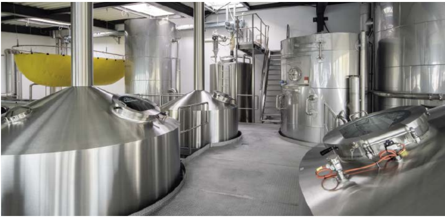
■ Abb. 5: Das Energierückgewinnungssystem Equitherm Brew sorgt für eine höchstmögliche Energieeffizienz.
