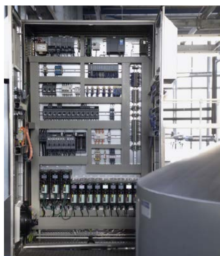
■ Abb. 3: Schrank, komplett ausgestattet mit Siemens-Produkten: Mit der Softwareumstellung erfolgte die Modernisierung wesentlicher Komponenten. Diese wurden direkt in das neue Leitsystem, das nur noch aus einem einzigen Schaltschrank besteht, integriert.
