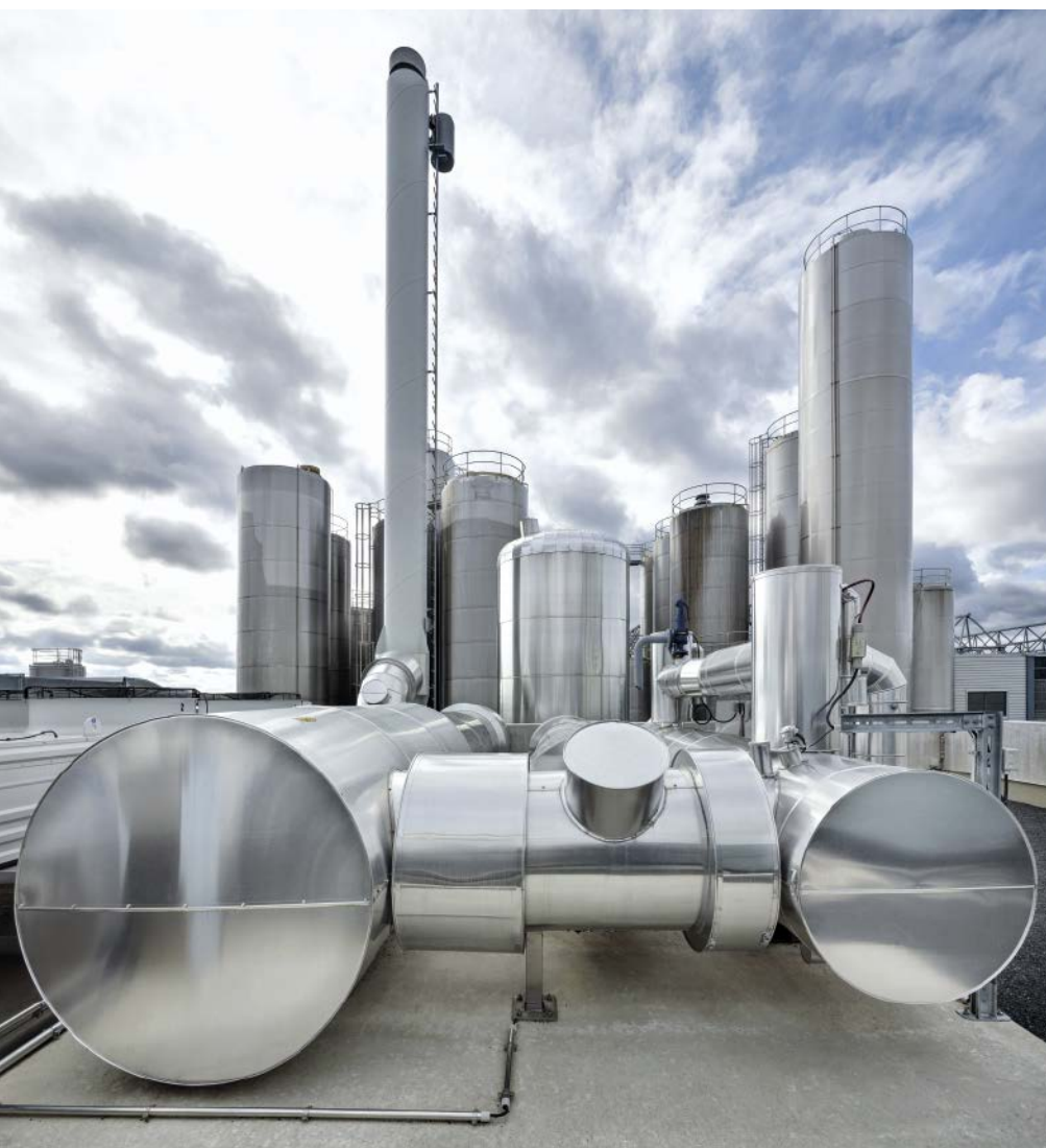
Abb. 1: Bei den Milchwerken Oberfranken West wurde ein eigenes BHKW installiert und in ein dampfbasiertes Prozesswärmesystem eingebunden. Dadurch konnte eine jährliche CO 2 -Einsparung von rund 5.000 t erzielt werden.
