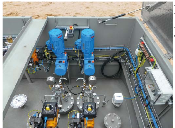
Abb. 3: Mit der Variante einer komplett verschweißten Pendelleitung blieb die hydraulische Verbindung zwischen Pumpenkopf und Treibkopf absolut dicht, sodass ein zuverlässiger Antrieb des Pumpenkopfs im Tank sichergestellt war.
