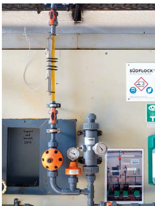
Abb. 2: Die Fällmittelzuführung mit dem Clamp-on-Durchflussmesssystem an dem transparenten Abschnitt der Fällmittelleitung
