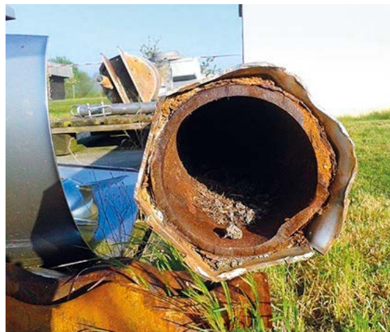
Abb. 2a: Korrodierte und gebrochene, verkleidete Stahlwelle nach geringer Einsatzzeit in einem Biogasfermenter.
