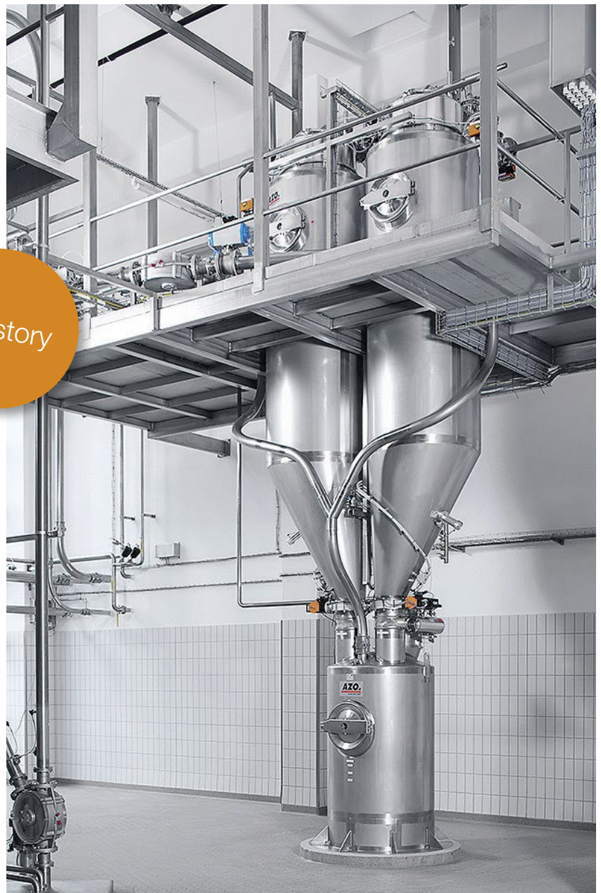
Abb. 1: Förderanlage unter Stickstoffschutzgasatmosphäre für Milchpulver
