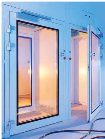
Abb. 2: Zwei Materialschleusen mit jeweils zwei Türen und einer elektronischen Verriegelung gewährleisten, dass der Druck im Reinraum immer erhalten bleibt.
