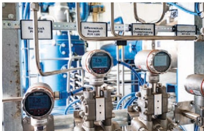
Abb. 3: Aerzen lieferte für EWE eine einbaufertige Komplettlösung inklusive Verrohrung und Anbindung an die Steuerungsebene.
