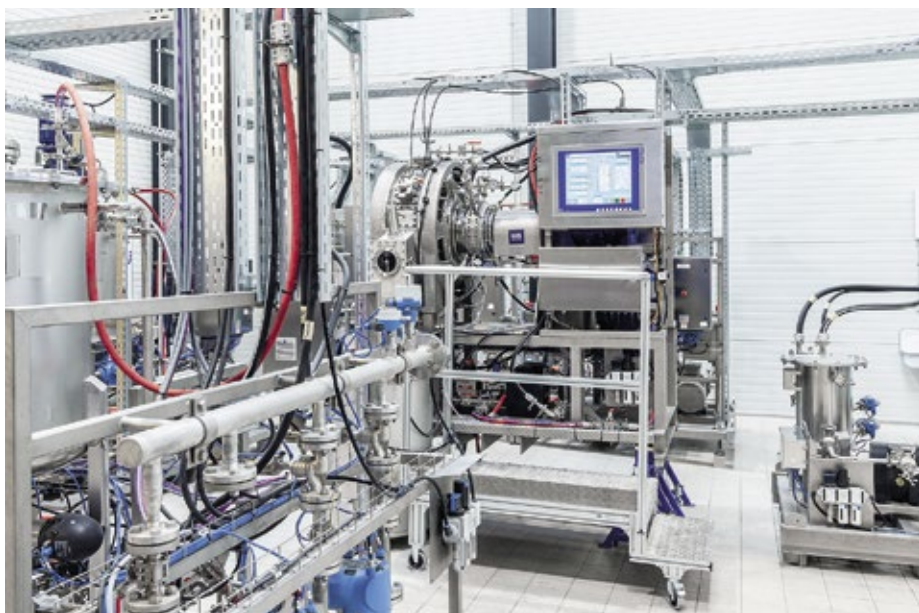
Abb. 3: Jede einzelne Station ist mit den erforderlichen Messgeräten und Regelarmaturen bestückt. Dazu zählen Durchflussmesser, Geräte zur Erfassung der Füllstände in den Behältern und Temperaturmessung.
