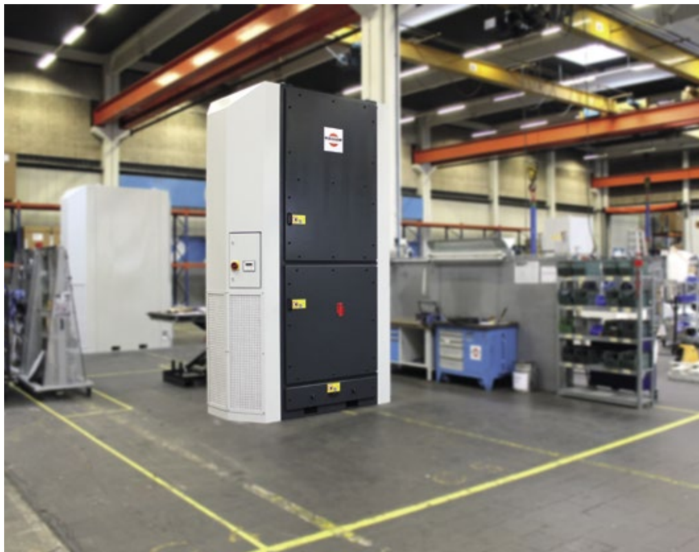
■ Abb. 2: Der Ambitower saugt staubbeladene Luft im oberen Hallenbereich ab und führt sie im Aufenthaltsbereich der Mitarbeiter gereinigt zu. Das senkt die Luftbelastung mit Feinstaub, Viren, Bakterien, Pilzen, Pollen und Sporen drastisch.
