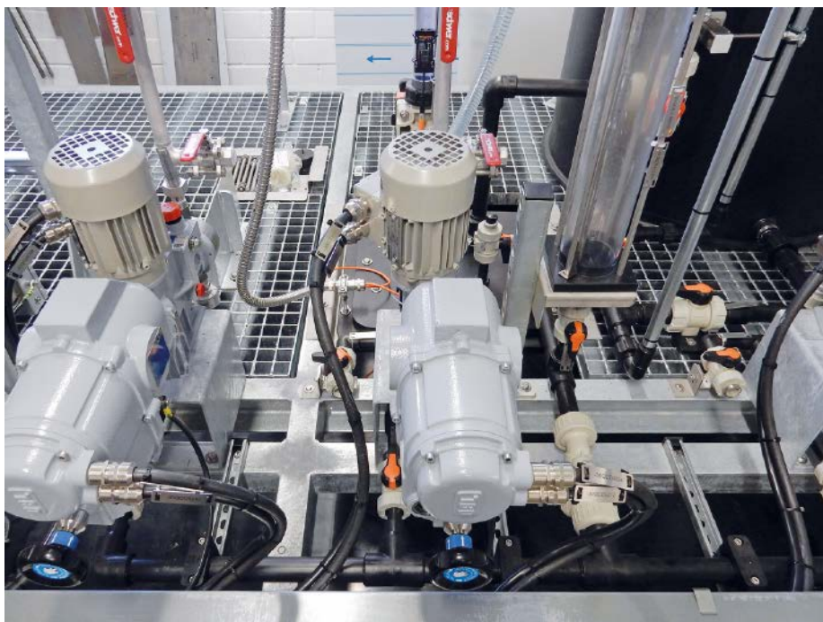
Jumo-Sensorik im Einsatz zur exakten und wiederholgenauen Dosierung von Ammoniaklösung.
