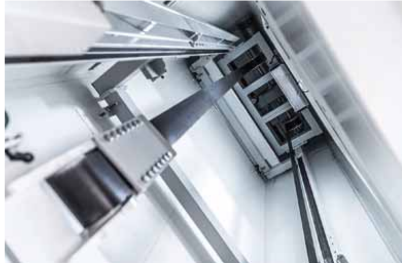
Abb. 6: Reinraumaufzug aus Logistikbereich „CNC“ in die Vorbereitung Klasse „C“
