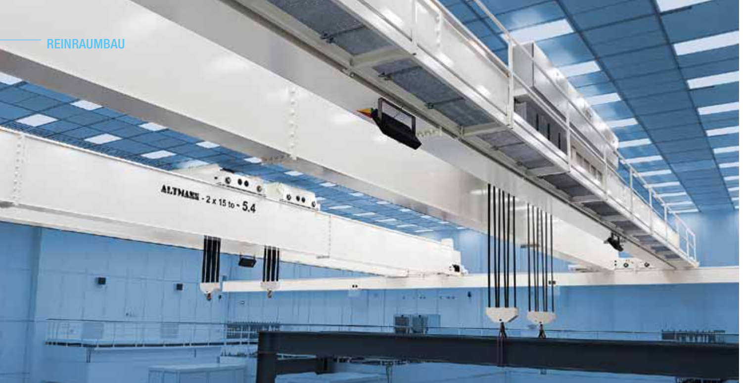
Gesamtansicht der Krananlage
