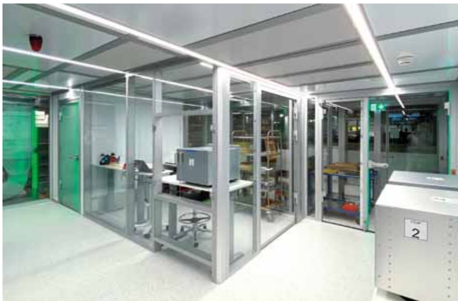
Abb. 1: Vollverglaster ISO-5-Reinraum CleanCell4.0 für die neue Sputteranlage
