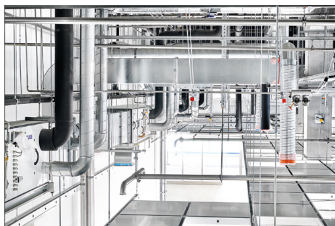
Abb. 3: X-Cube CROFCU kann in den Zwischendecken untergebracht werden.
