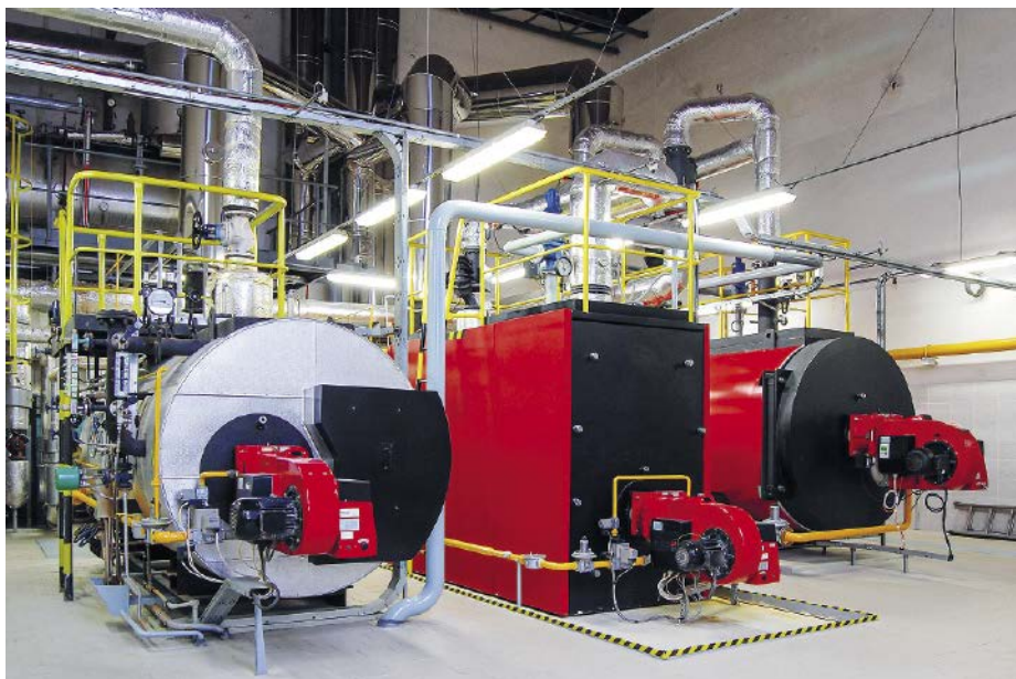
■ Abb. 2: Eine Alternative zur einer Dampferzeugung mit Erdgas oder Heizöl bieten Elektro- oder Elektrodenkessel.
