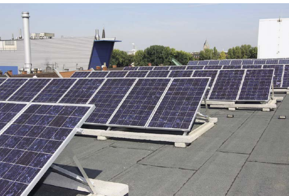
■ Abb. 1: Mittels Contracting können Unternehmen ohne eigene Investitionen von Strom aus Erneuerbare-Energien-Anlagen profitieren.
