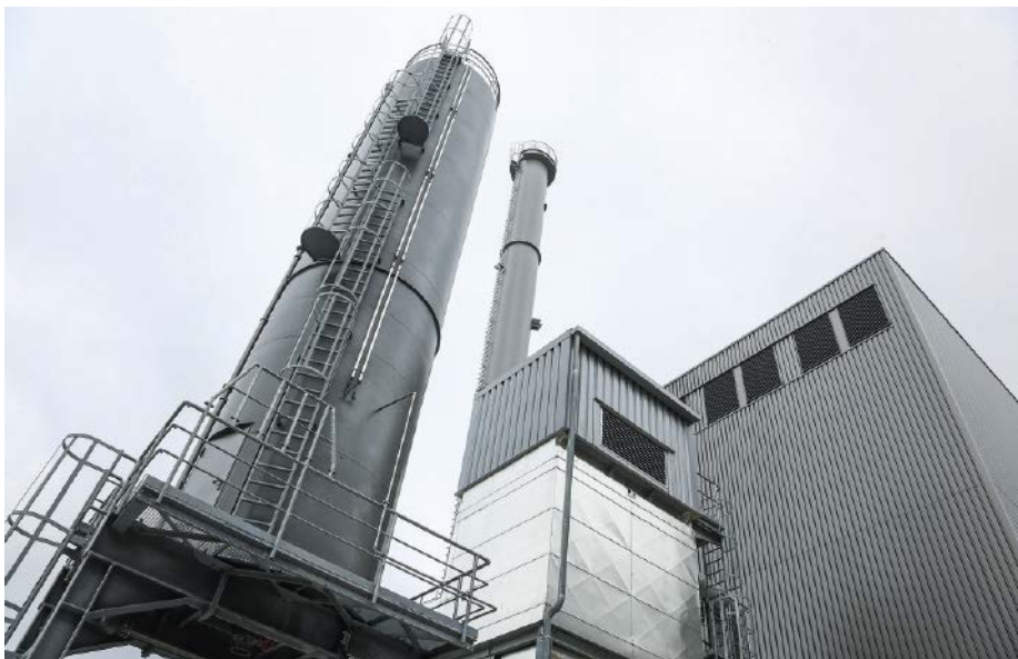
■ Abb. 3: Der Kakaobohnenverarbeiter OFI hat die neue Biomasse-Kesselanlage am Standort Mannheim mit MVV Enamic als Contractor umgesetzt und konnte sich so auch während der Planungs- und Bauphase auf sein Kerngeschäft konzentrieren.
