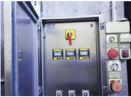
■ Abb. 2: Die gemessenen Werte des Vegapuls-Füllstandsensors erfasst das Auswertgerät Vegamet 391 und können von dort für weitere Steuer- und Regelungsaufgaben genutzt werden.
