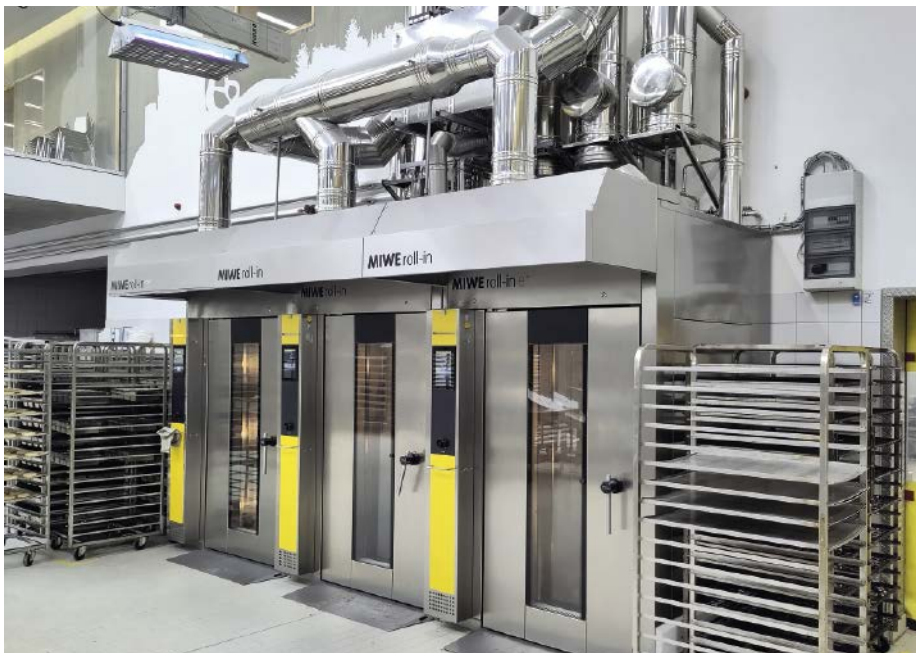
■ Abb. 2: Die Bäckerei und Konditorei Treiber in Steinenbronn spart durch Abwärmerückgewinnung rund 350 MWh/a Energie bzw. 95 t CO 2 /a.
