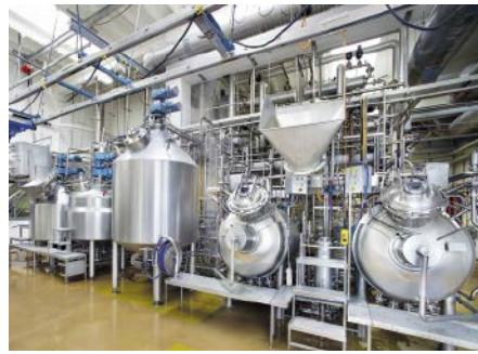
■ Abb. 3: Pasteurisationsanlage – künftig sollen Unternehmen entstehende Abwärme vermeiden bzw. auf den technisch unvermeidbaren Anteil verringern.
