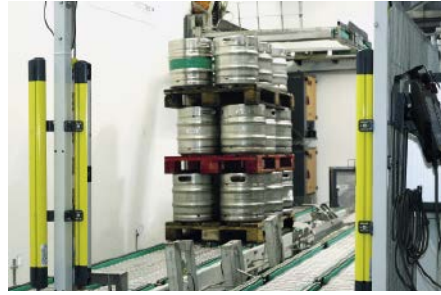
■ Abb. 3: Leuze Mehrstrahl-Sicherheits-Lichtschranken des Typs MLD 500 sichern den Arbeitsbereich der Roboter gegen Zugang von außen ab.
