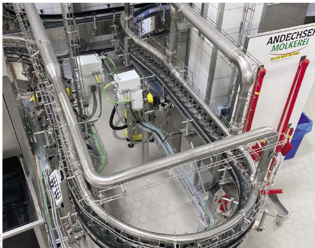
■ Abb. 2: Dank guter Erfahrungen mit dezentralen Antrieben von SEW-Eurodrive kommen bei der neuen Anlage die aktuellen Movigear performance zum Einsatz.
