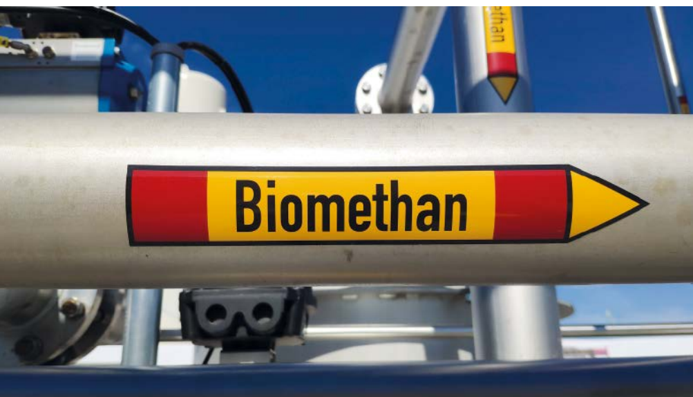
■ Abb. 1: Die Biogasaufbereitung mit anschließender Einspeisung von Biomethan ins Gasnetz oder die Methanisierung des CO 2 -Anteils von Biogas mit grünem Wasserstoff aus der Elektrolyse bieten große Potenziale.
