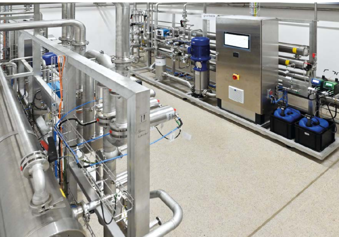
■ Abb. 1: Zwei baugleiche Grünbeck-Umkehrosmoseanlagen vom Typ RK-X 20.000 S hat Auerbräu im Gewölbekeller installiert. Jede von ihnen produziert bis zu 20 m 3 vollentsalztes Wasser pro Stunde.
