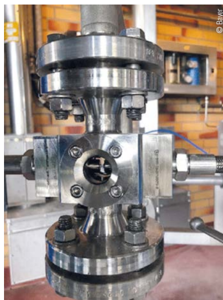
Abb. 4: NIR-Sonde in einem Rohr der Ethanol-Recyclinganlage
