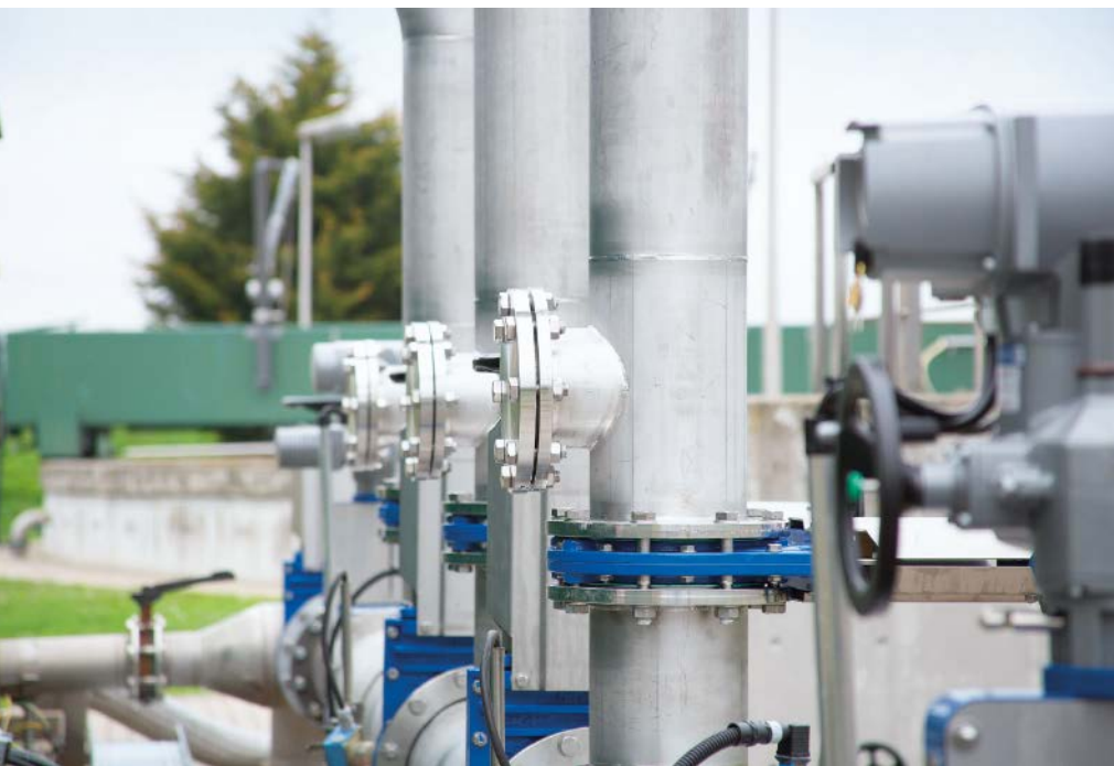
Die drei Turbogebälse liefern insgesamt 9.000 Nm³/h Prozessluft.
