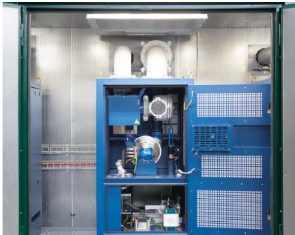
Blick in einen der Aerzen Turbos im Container.
