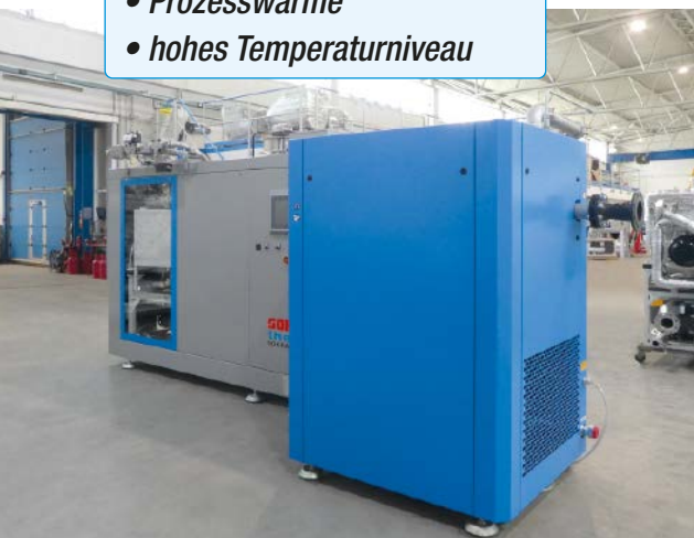
In dem GK-Modul werden die Hauptkomponenten eines Blockheizkraftwerkes direkt mit einem Schraubenkompressor gekoppelt.
