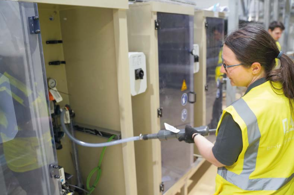
Einstellung der Dosieranlagen
