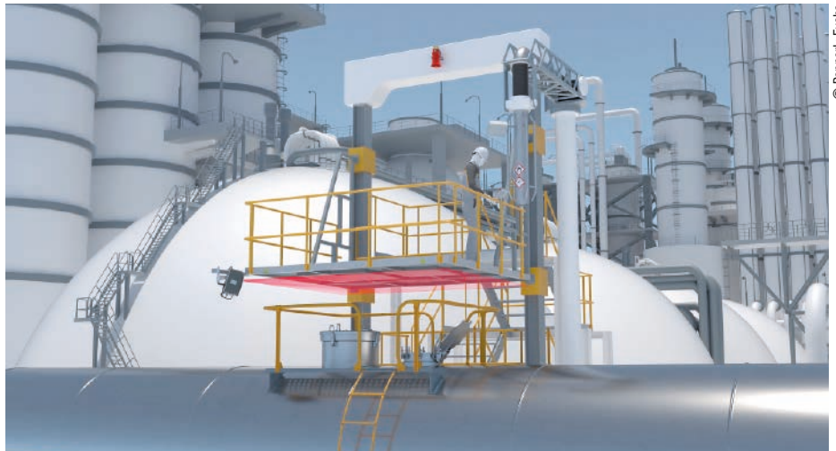
Abb. 2: Hebebühne mit Absturzsicherung überwacht durch den 2-D-LiDAR-Sensor R2000.
