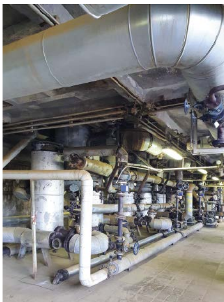
Abb. 2: Der Einsatzort der effizienten Magnetkuppelungspumpe in der Verdampferanlage.
