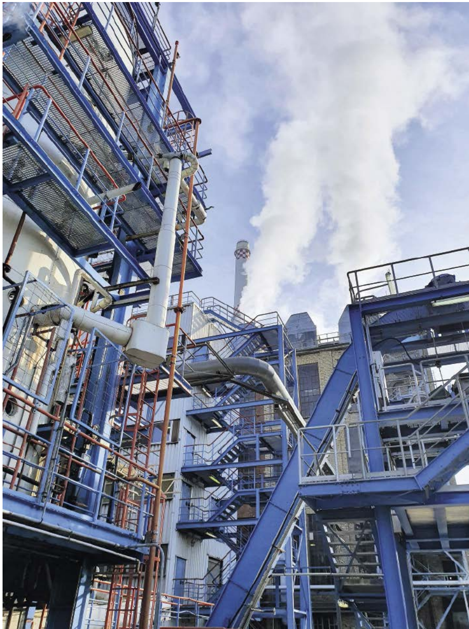
Abb. 1: Extraktionsanlage für die hohen Anforderungen des Produktionsprozesses.
