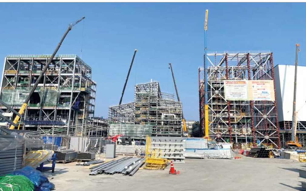
Aufbau einer Anlage für die Wiedergewinnung von Lithiumhydroxid-Monohydrat
