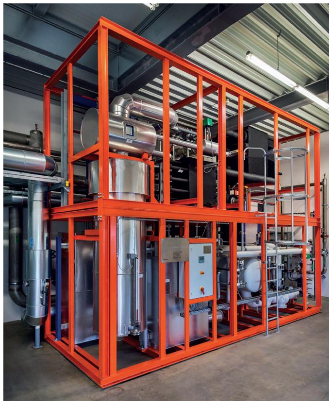
Das neue BHKW der Molkerei Gropper in der Innenansicht, die Inbetriebnahme der zweiten Ausbaustufe ist für Februar 2014 geplant.
