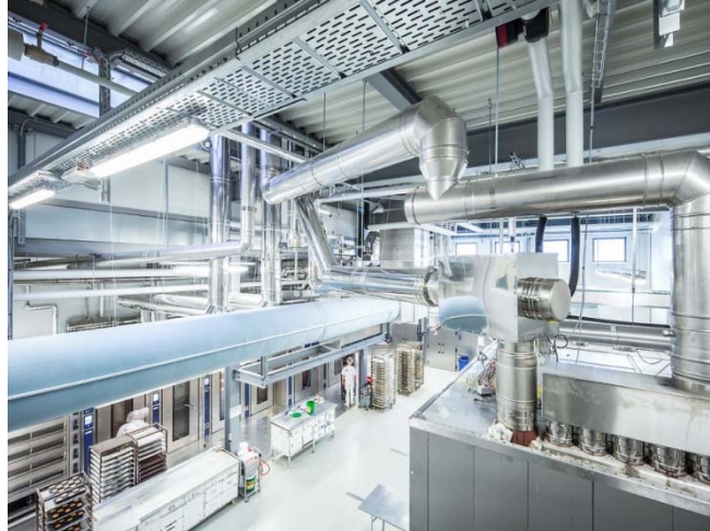
Bild: Die Anforderungen und Bedürfnisse der Gebäudetechnik müssen früh in die Planung mit einbezogen werden, damit die Installationen sauber ausgeführt werden können.
