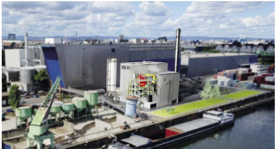
■ Abb. 2: Direkt am Mannheimer Hafen setzt MVV Enamic für den Kakaoproduzenten OFI eine hochinnovative Dampferzeugungsanlage um. Hier ein Blick ins Innere des Anlagengebäudes.
